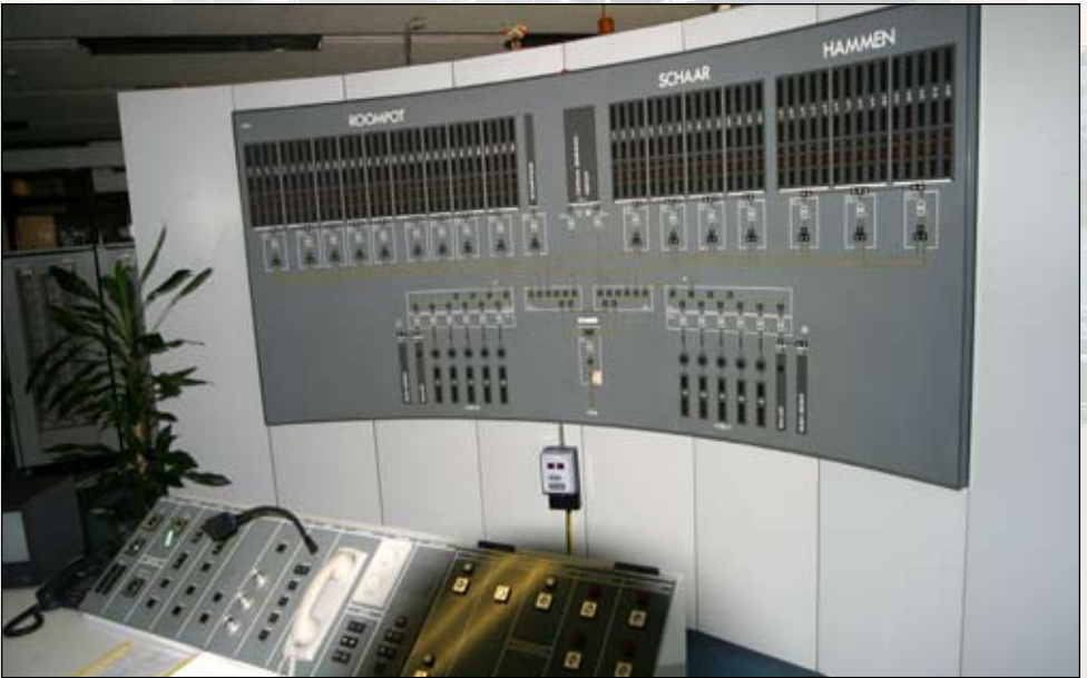
Het bedieningspaneel in de bedieningsruimte van het ir. J.W. Topshuis
