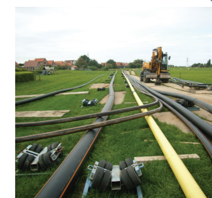
Kabels en leidingen
