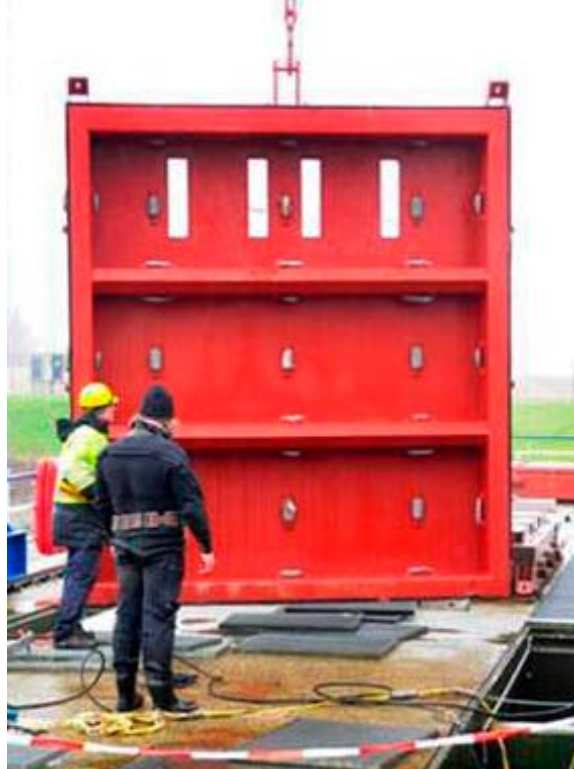
De 'brievenbussen' voor vismigratie in de gemaalsschuiif
